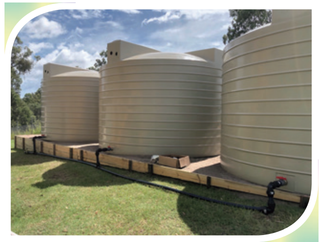
Accensi採用逆滲透處理技術，處理受污染雨水供產品重用，代替使用城鎮供水，節省寶貴資源。
