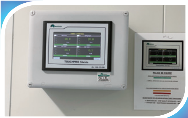
Lipa安裝了危險氣體監測系統確保在質量控制實驗室內僱員的安全。
